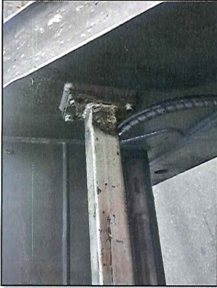
Local: Spreader Item # 26: guia das mangueiras hidráulicas do spreader amassada.
