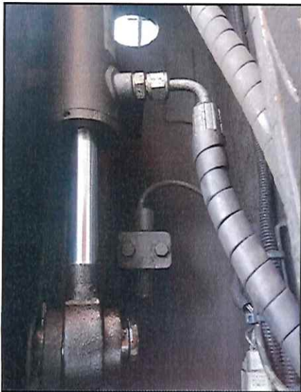
Local: Spreader Item # 16: pequeno vazamento de óleo nos cilindros de acionamento dos twist-locks .
