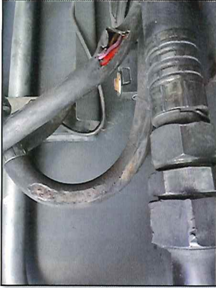
Local: Lança Item # 45: mangueira e chicote elétrico raspando na calha da esteira cable track.
